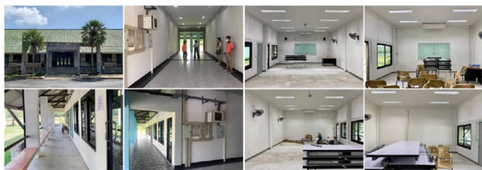
แสดงสภาพภายในพื้นที่อาคารที่ทรุดโทรมและไม่สามารถใช้งานได้เป็นอย่างดี
